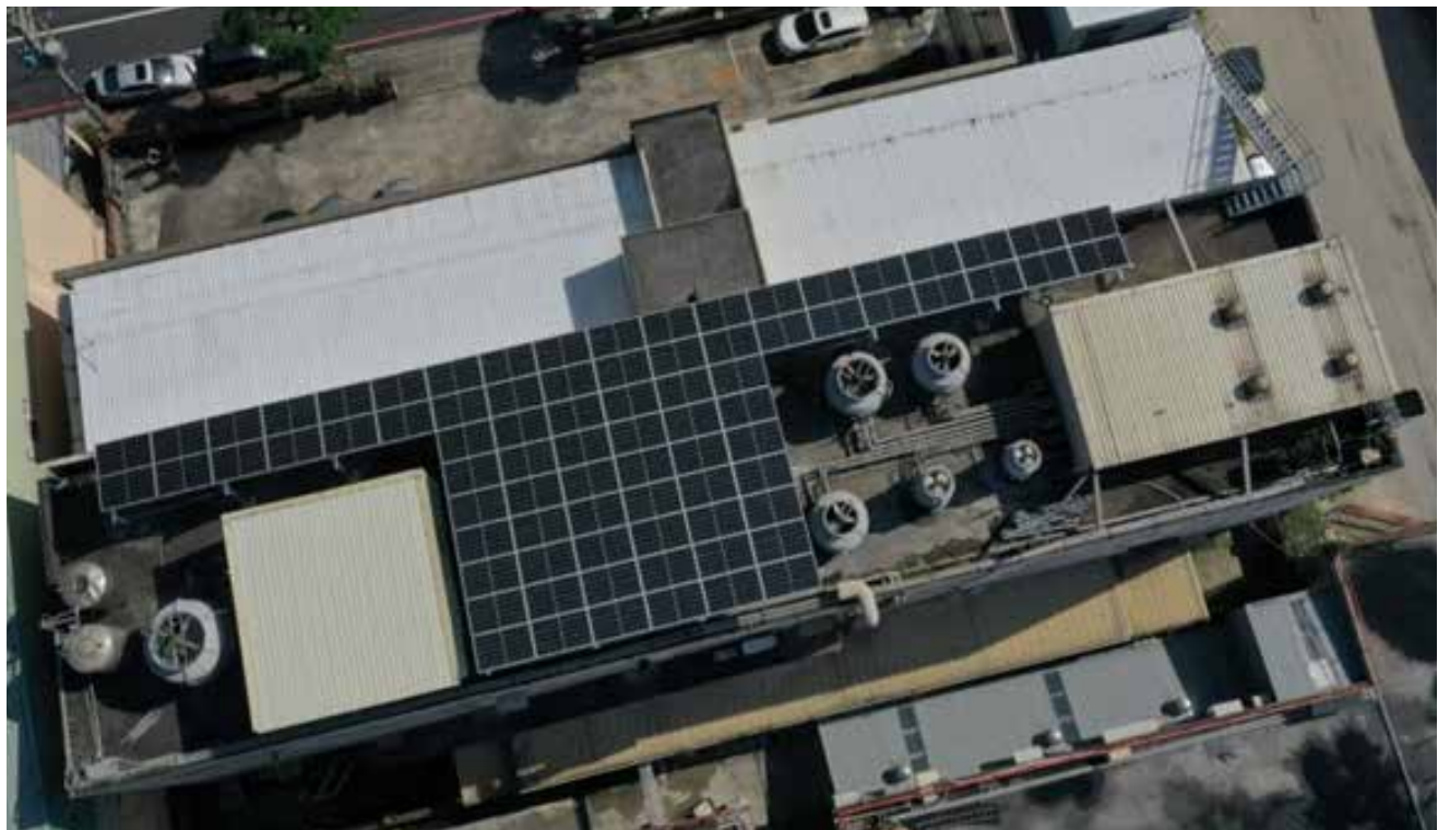
桃園廠新建太陽能發電廠空拍照
